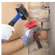
Lošu žbuku treba ukloniti
