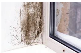
Slika 83 Rast gljivica i plijesni zbog kondenzacije na špaleti prozora
