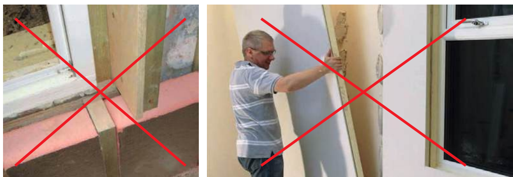
Slika 2-42 Prikaz loše ugradnje sustava unutarnje toplinske izolacije [106], [107]
