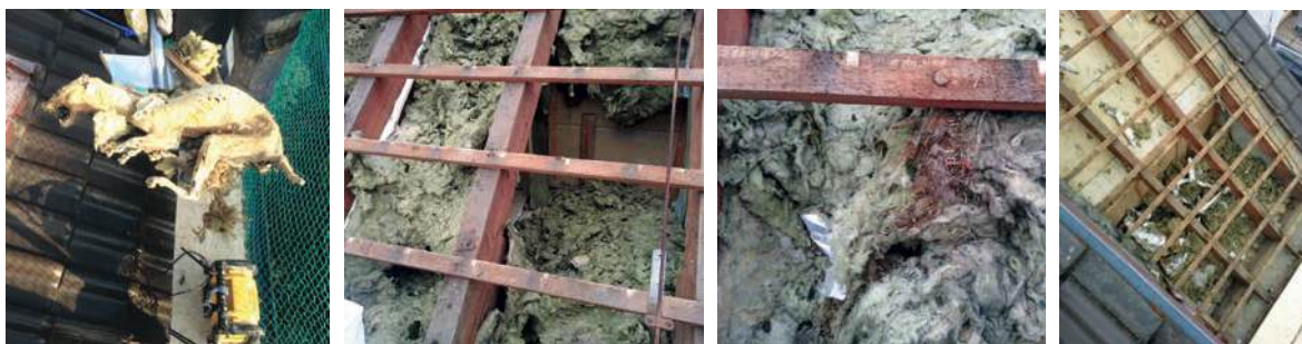
Slika 2-97 Oštećenje toplinske izolacije zbog glodavaca [138]
