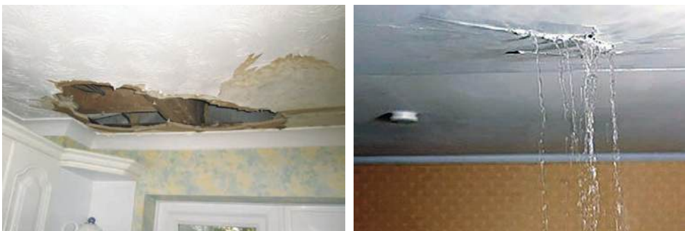
Slika 1-76 Štete uzrokovane lošom izvedbom kišne brane [76], [77]
