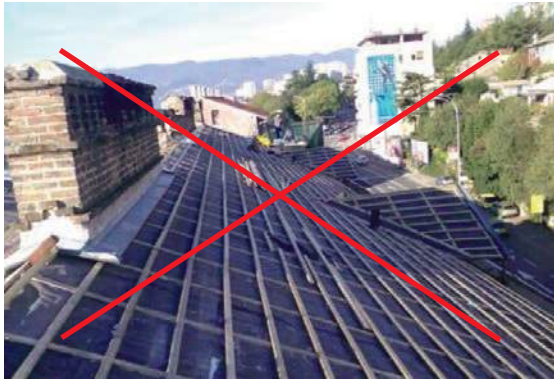
Slika 2-88 Primjer bitumske ljepenke na krovu - izbjegavati [72]
