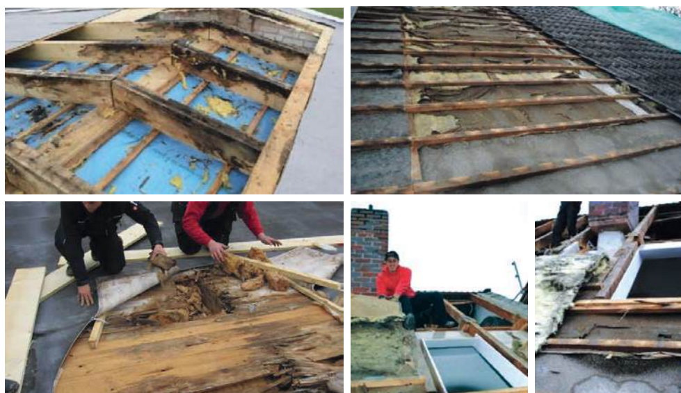
Slika 2-92 Primjer vlažnog i trulog drvenog krova [133]
